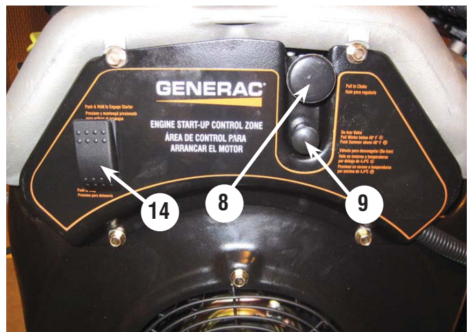
Figura 6 - Panel de control del motor
